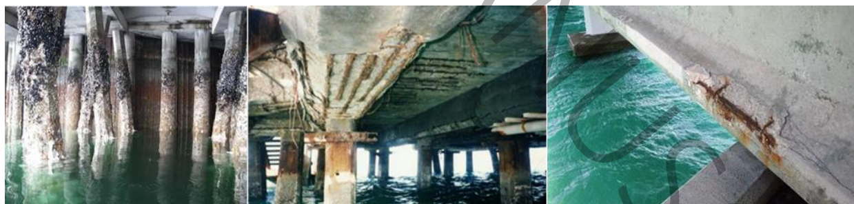
شکل ۱ تخریب بتن ستون اسکله و کاور بتن یک سازه دریایی تحت شرایط خوردنده [۱، ۲، ۳]
