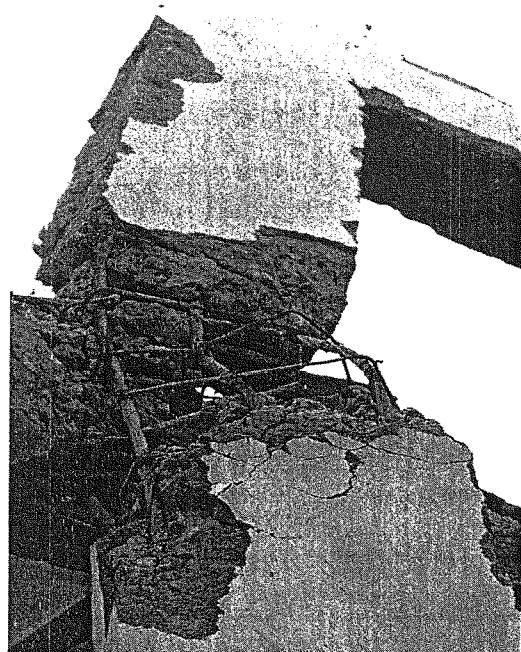
شکل (۳): مخزن هوایی آب با حجم ۱۰۰ مترمکعب که در اثر طغیان نامناسب اتصالات در زلزله ی سال ۲۰۰۱ بوج هند فرو ریخت [۱۰].
