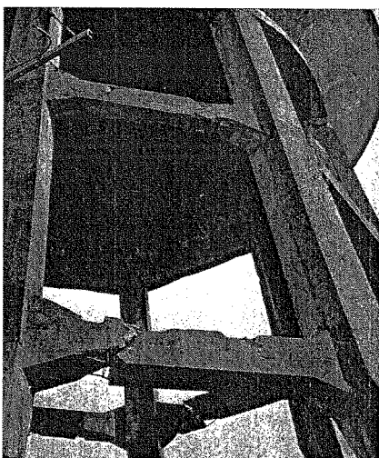
شکل (۲): تشکیل مفصل ها و ترک های برشی - خمشی بر روی تیرهای پایه ی یک مخزن هوایی در زلزله ی سال ۱۹۶۰ شیلی [۱۱].
