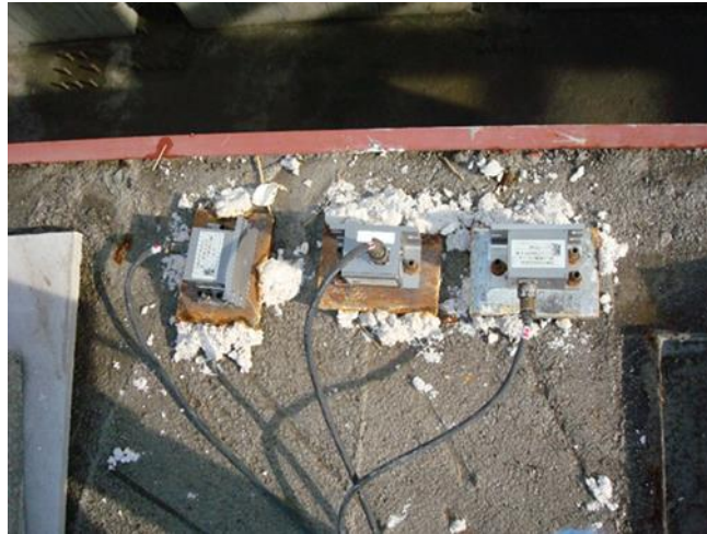
شکل ۳. شتابنگارهای نصب شده بر روی پی میز لرزه Fig. 3. Installed sensors on the foundation of table
