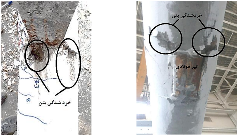
ب: خرد شدگی بتن در ناحیه رویه اتصال RCS نمونه دوم
