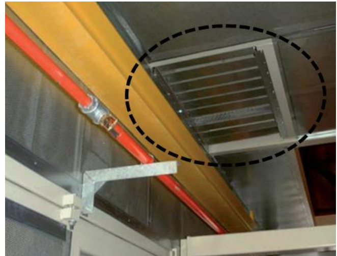
شکل ۹: دریچه تهویه اتاق یک توربین گاز
