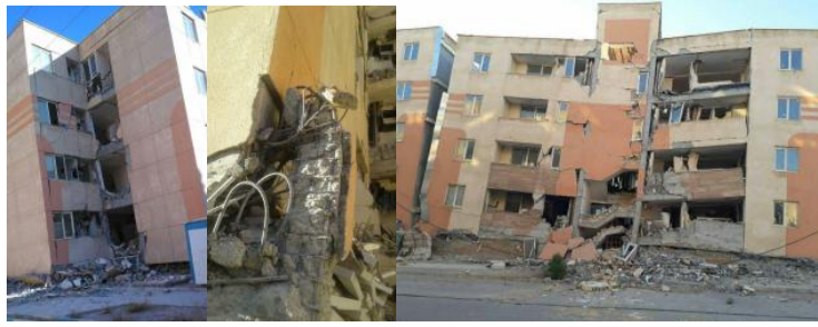
شکل ۱. خسارت ناشی از اثر طبقه نرم در زلزله کرمانشاه ۱۳۹۶
