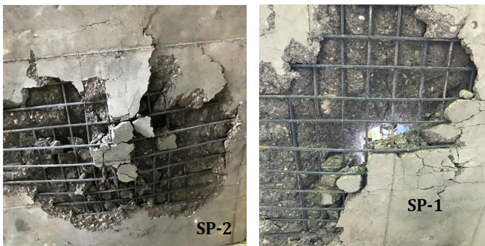
شکل ۱۰: مقایسه آسیب بتن در مخروط پانچینگ در نمونه‌های SP-۱ و SP-۲ در ناحیه کششی Fig. 10. Comparison of damaged concrete in punching cone between SP-1 and SP-2 specimens
