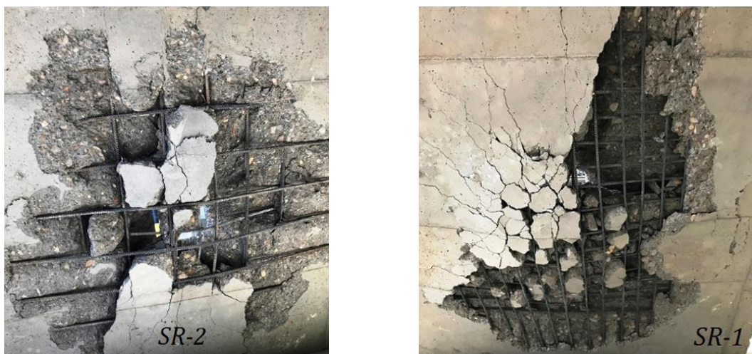
شکل ۱۳: مقایسه آسیب بتن مخروط پانچینگ در نمونه های SR-۱ و SR-۲ (ناحیه کششی دال)
