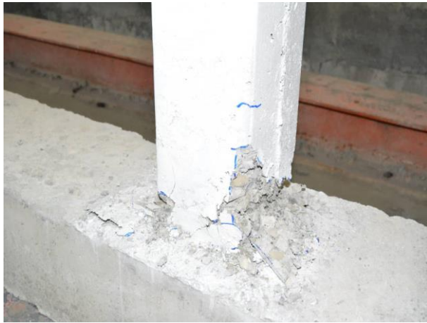
ب) آسیب‌های نمونه در محل اتصال به فونداسیون
