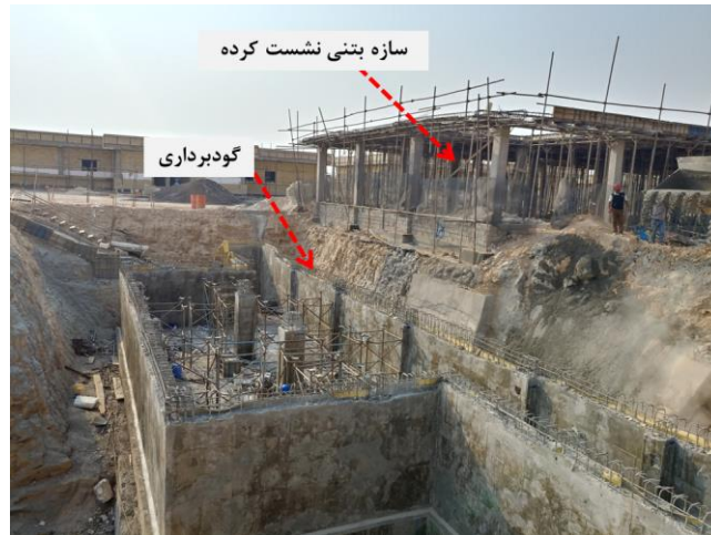
شکل ۱. ساختمان بتنی در حال ساخت در مجاورت گودبرداری دچار نشست شده است.
