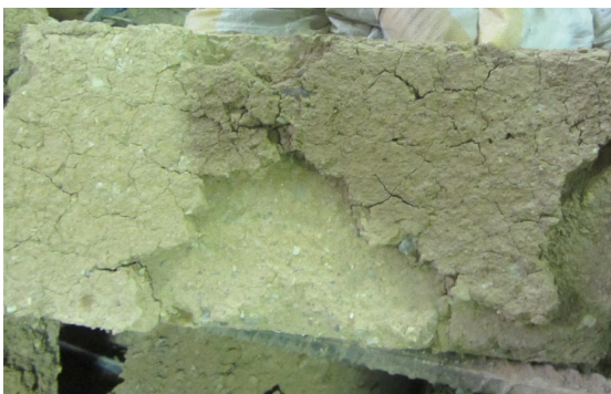
شکل ۱۸: ترک‌های ایجاد شده در ملات دیوار ساده بعد از آزمایش
